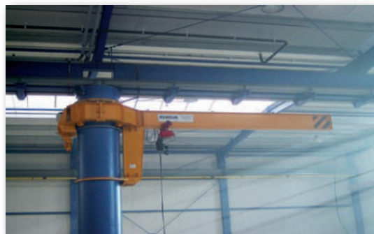
Колонный кран GSOJ 2t/6m на колонне цеха
