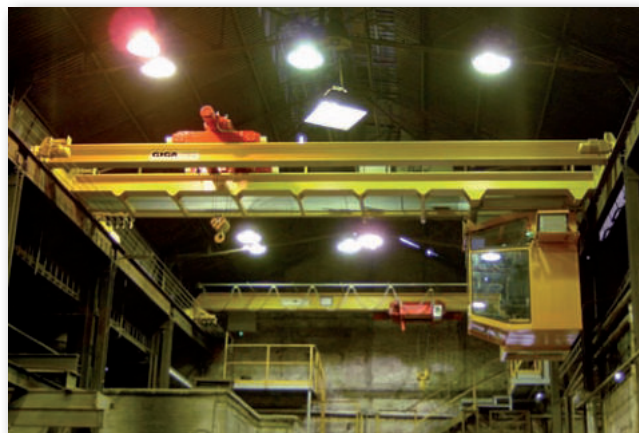
Мостовой кран GIGA mun GDMJ 3,2t/9,43m в сталелитейном исполнении с кабиной
