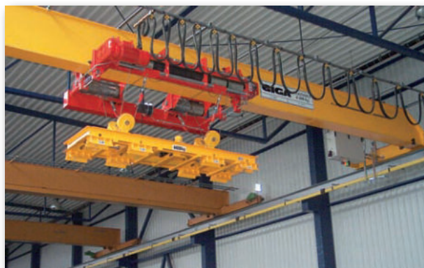
Мостовой кран GIGA mun GJMJ 4,4t/27,5m с магнитной траверсой с канатной стабилизацией
